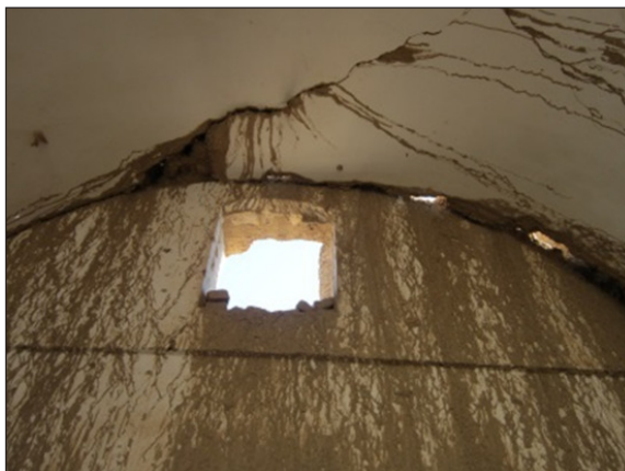
تصویر ۱۲. ترک بین دیوار و طاق در خانه شماره ۱۰ (زمستان ۱۳۹۵).
