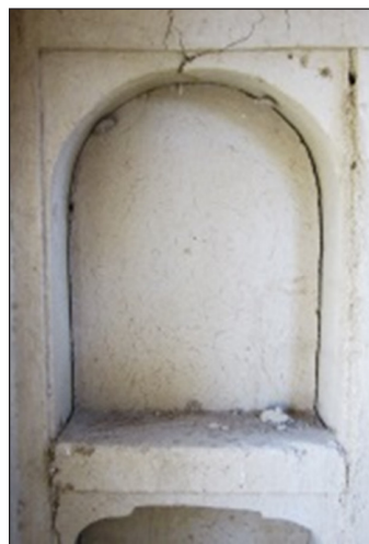
تصویر ۲۶. ایجاد ترک در انحنای طاقچه در خانه شماره ۸ (زمستان ۱۳۹۵).
