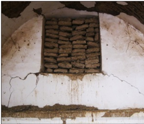
تصویر ۲۳. ترک در اطراف بازشو در خانه شماره ۳ (پاییز ۱۳۹۴).
