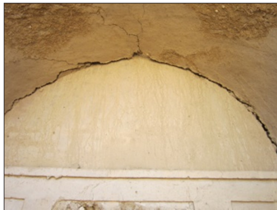
تصویر ۱۱. ترک بین دیوار و طاق در خانه شماره ۱ (پاییز ۱۳۹۴).
