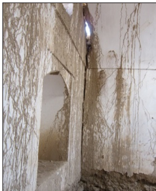
تصویر ۱۰. ترک گوشه در خانه شماره ۳ (زمستان ۱۳۹۵).
