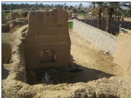
تصویر ۱۷. واژگونی خارج از صفحه دیوار در خانه شماره ۳ (پاییز ۱۳۹۴).
