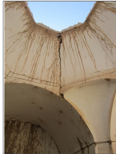
تصویر ۲۰. ترک نصف‌النهاری در طاق خانه شماره ۱۰ (زمستان ۱۳۹۵).
