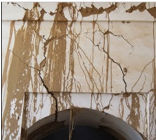
تصویر ۲۴. ایجاد ترک بازشو در خانه شماره ۱۰ (زمستان ۱۳۹۵).
