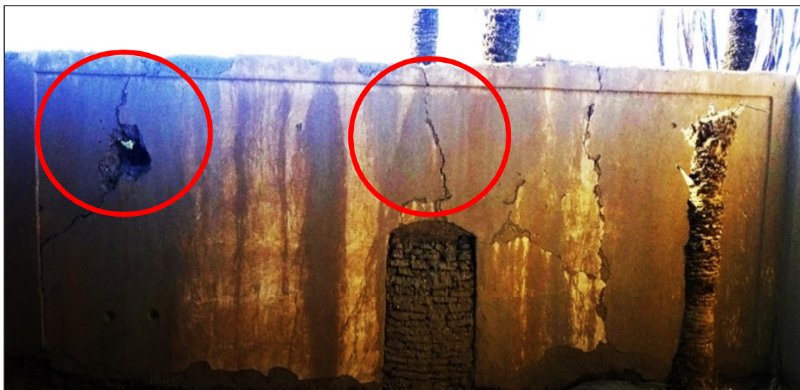
تصویر ۲۹. رخدادهای ترک‌های داخل صفحه دیوار در خانه شماره ۴ (زمستان ۱۳۹۵).
