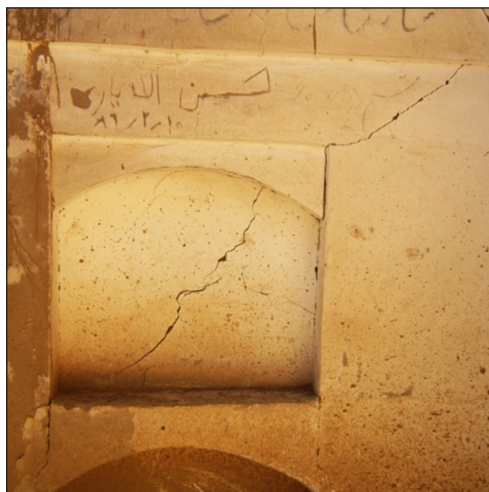
تصویر ۲۵. ایجاد ترک قطری در طاقچه خانه شماره ۴ (پاییز ۱۳۹۴).
