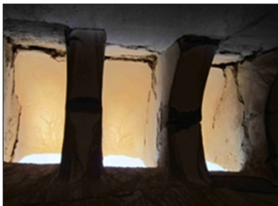
تصویر ۲۷. ترک در تیغه‌های بادگیر در خانه شماره ۹ (پاییز ۱۳۹۴).
