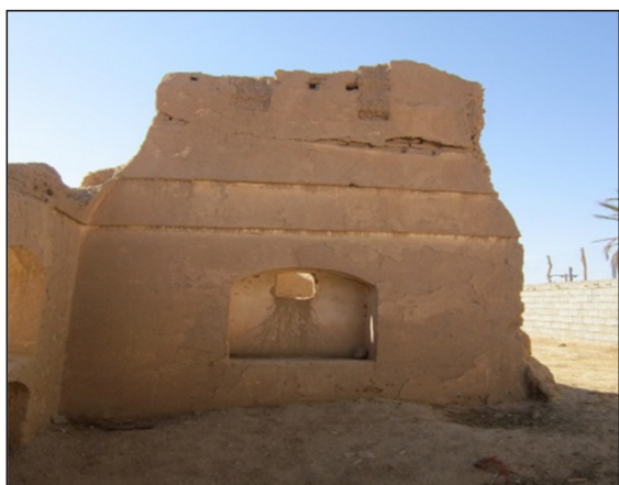
تصویر ۲۸. تخریب و ریزش بادگیر در خانه شماره ۳ (پاییز ۱۳۹۴).
