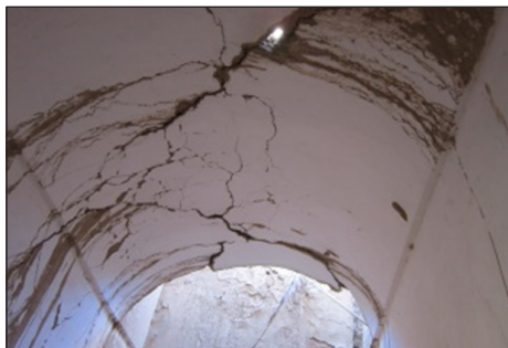
تصویر ۱۹. ایجاد ترک با مکانیزم پیچیده در طاق خانه شماره ۱۰ (زمستان ۱۳۹۵).
