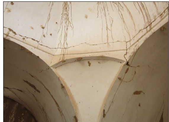
تصویر ۲۱. ترک مداری در طاق خانه شماره ۱۰ (زمستان ۱۳۹۵).
